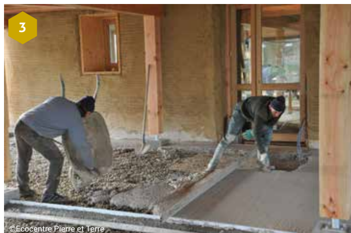
3 - La chaux, aussi efficace sur murs extérieurs que pour la composition de dalles (projet de l'Ecocentre Pierre et Terre dans le Gers.)
